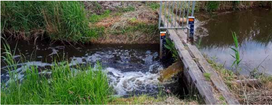
Figuur 3.3.: Op 22 mei 2017 is de schuif in de bestaande keerwand opengezet. Het duurde circa 5 dagen voordat het peil in dijksloot (links) gelijk was aan het boezempeil (rechts).
