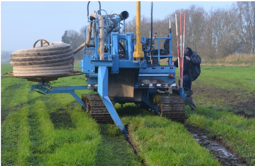
Figuur 2.4 Aanleg drains door Barth Drainage B.V. ten behoeve van het IPV-onderzoek naar de werking van drukdrains.
