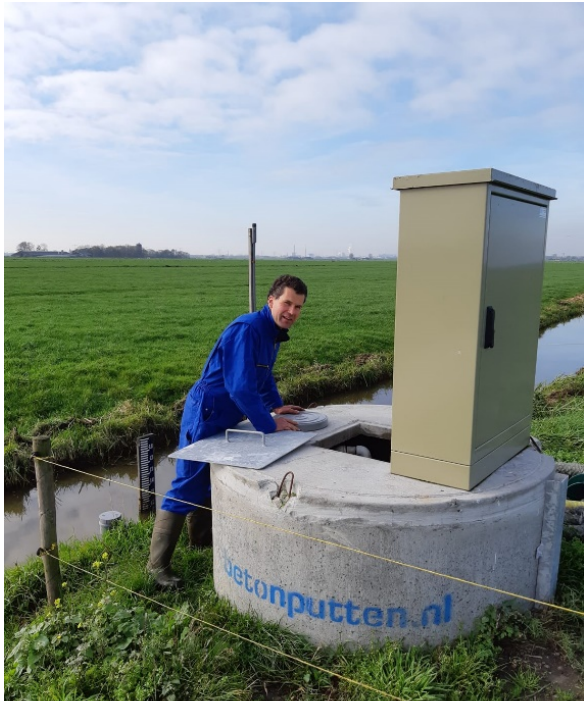
Figuur 2.7 Waterreservoir waar de onderwaterdrains op aangesloten waren en met pompen het streefpeil voor de grondwaterstand kon worden gerealiseerd. In de kast die op de put was gemonteerd bevond zich het besturingssysteem voor het instellen van de streefpeilen en het aan- en uitschakelen van de pompen voor draineren en infiltreren.
