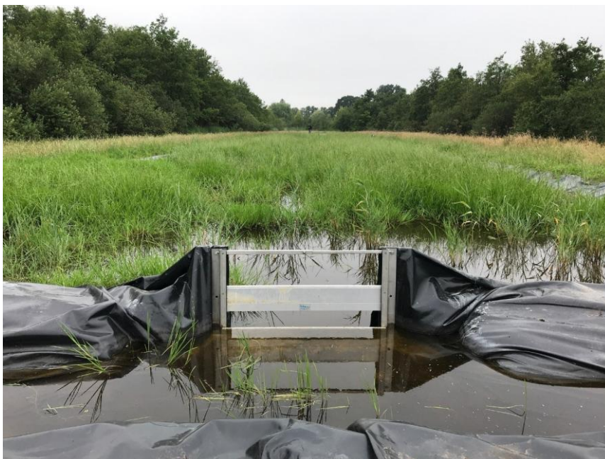
Figuur 6. Inlaatsluis voor proefvak 5 met riet.
