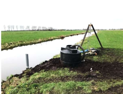
Links een moderne kleine vulput, gevuld met een frequentie-gestuurde pomp; rechts groter en ouder model vulput
